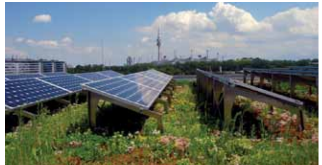
Die Kombination von Dachbegrünung und Photovoltaik erfordert einen gewerkeübergreifenden Informationsaustausch.
