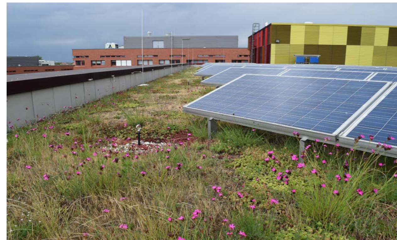
Abb. 6: Extensive Dachbegrünung, hier in Kombination mit Photovoltaik (Solar-Gründach). Quelle: BuGG
