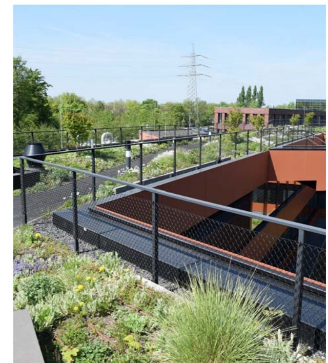
Abb. 34: Der Großteil der Dachbegrünungen, unabhängig ob extensiv oder intensiv, werden mehrschichtig gebaut. Quelle: BuGG
