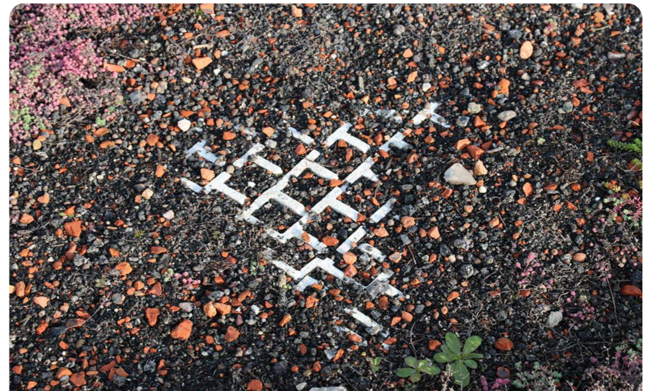
Abbildung 44: Substratverwehungen (Pflegeempfehlung: Abstreuen der Fläche mit Substrat und Sedumsprossen und anschließend bewässern)
