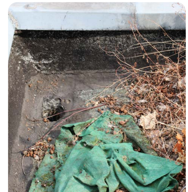
Abbildung 14: Schäden auf einer Dachbegrünung
