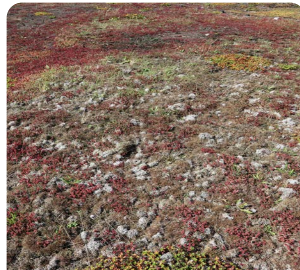
Abbildung 40: Nährstoffmangel auf einer Moos-Sedum-Vegetation mit zusätzlichen Trockenstresssymptomen (Pflegeempfehlung: Düngung vorzugsweise im Frühjahr mit einem Langzeitdünger und Zusatzbewässerung, wenn dies ökologisch und ökonomisch vertretbar ist)
