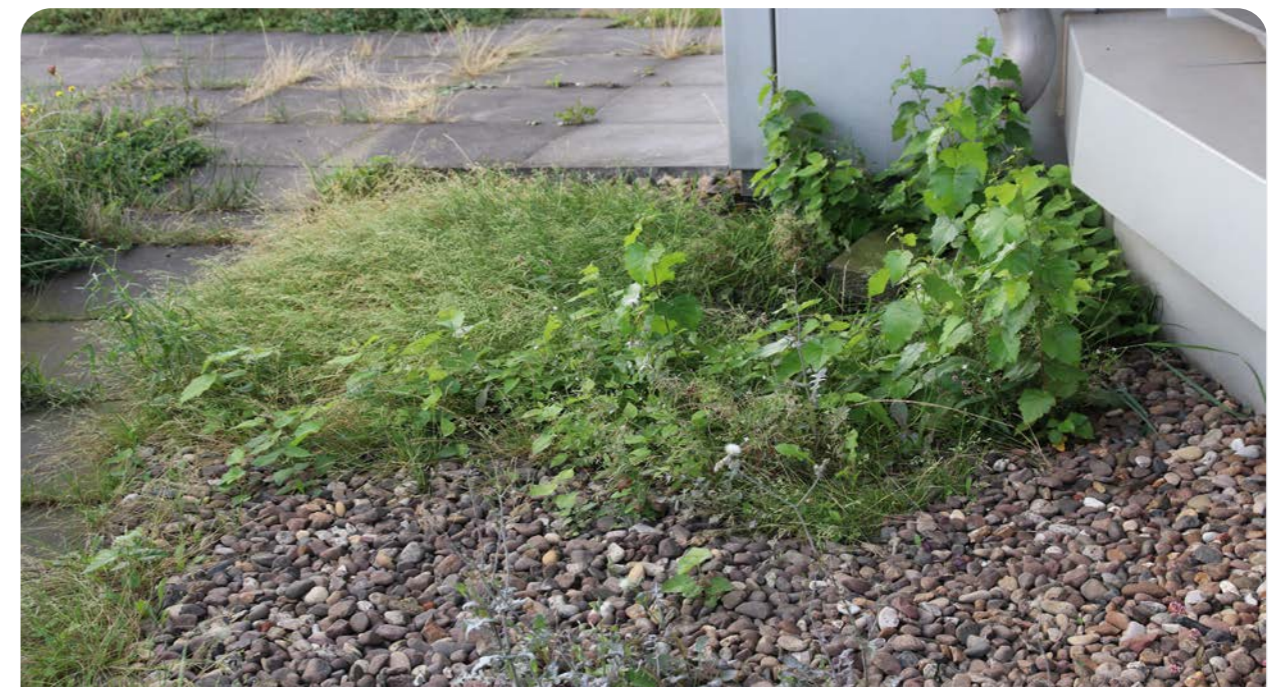
Abbildung 49: Bewachsener Kiesrandstreifen (Pflegeempfehlung: Entfernen der Pflanzen mit Wurzeln, hier können Sedumpflanzen auf dem Kiesrandstreifen toleriert werden)
