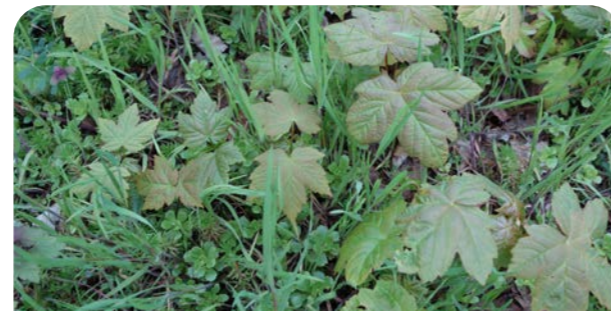
Abbildung 16: Unerwünschter Bewuchs von gekeimten Ahorn-Gehölzen und Kriech-Quecke auf einer extensiven Dachbegrünung (Pflegeempfehlung: Entfernung der Gehölze und der Quecke mit Wurzeln)
