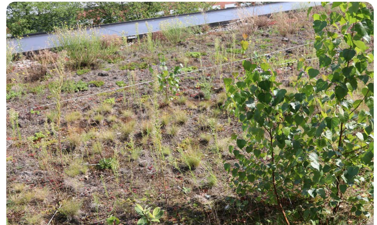
Abbildung 13: Nicht gepflegte Extensivbegrünung mit unerwünschtem Bewuchs (Gehölze und Beikräuter)
