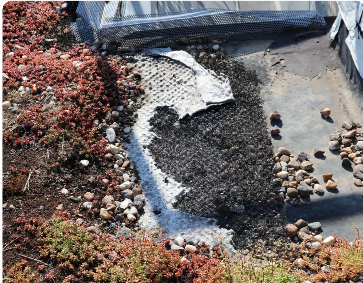
Abbildung 42: Freigelegtes Schutzvlies und beschädigte Dränagematte (Pflegeempfehlung: Sanierung der Dachbegrünung durch eine Fachfirma)
