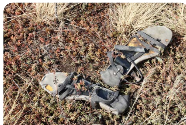
Abbildung 47: Unrat auf dem Dach (Pflegeempfehlung: fachgerechte Entsorgung des Unrats in den Hausmüll)
