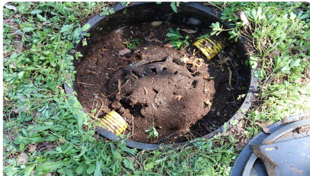
Abbildung 51: Verschmutzte Entwässerungseinrichtung (Pflegeempfehlung: Verschmutzung abtragen, Ausspülen der Entwässerungseinrichtung mit Wasser)
