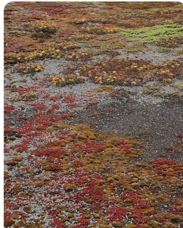
Abbildung 36: Fehlstellen in der Vegetation aufgrund von Nährstoffmangel (Pflegeempfehlung: Nachstreuen von Sedumsprossen vorzugsweise im Frühjahr oder Herbst, Düngung und Bewässerung)
