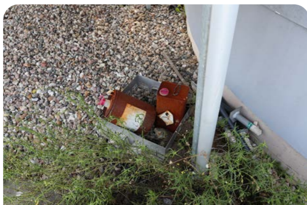
Abbildung 46: Unrat auf dem Dach (Pflegeempfehlung: fachgerechte Entsorgung des Unrats)
