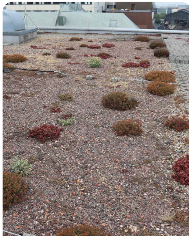
Abbildung 35: Fehlstellen in der Vegetation (Pflegeempfehlung: Nachstreuen von Sedumsprossen oder das Pflanzen von Kleinballenstauden vorzugsweise im Frühjahr oder im Herbst, Düngung und Bewässerung)
