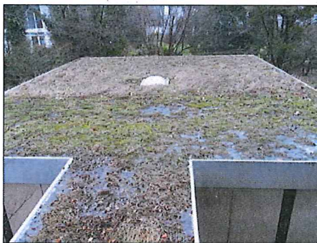
Abbildung 1: Wasseranstau auf gefällelosem Dach
