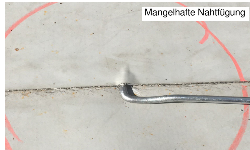
Fehlerursachen bei Dächern mit Abdichtungen
